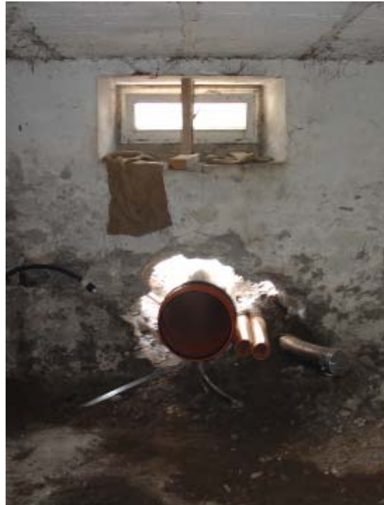
Bild: Fernwärmeleitung Neben-/Haupthaus
