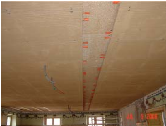
Bild: Lehmprodukte im Bereich der Deckenheizung des Rosensaals
