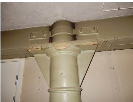
Detalj av en längsgående järnbalk och övre delen av en gjutjärnspelare i källaren, målade i grågrönt.
