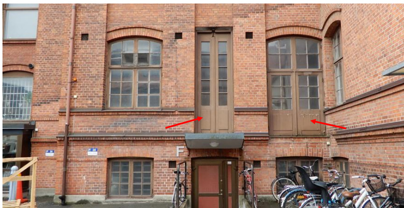
Ursprungliga, spröjsade fönster och två äldre, troligen ursprungliga dörrar på plan 1 i fasaden mot gården på tillbyggnaden från 1927. Källardörren är plåtklädd och tillkom år 2000. Till höger syns trapphuset.
