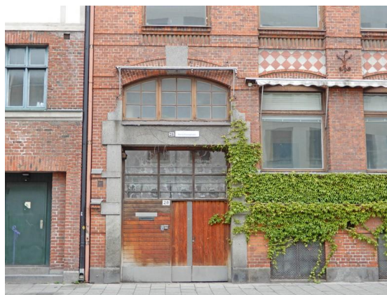
Port i västra delen av tillbyggnaden från 1927. Källarfönstren mot gatan är dolda bakom skivor av sträckmetall.
