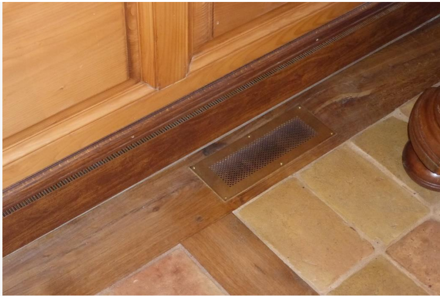
Figure 17 : Bouche de reprise de la VMC double flux (source : CREBA)
