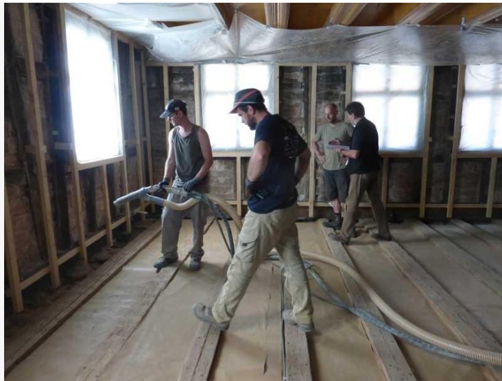
Figure 11 : Projection du béton de chanvre après protection des fenêtres et passage des gaines des canalisations et du réseau électrique
