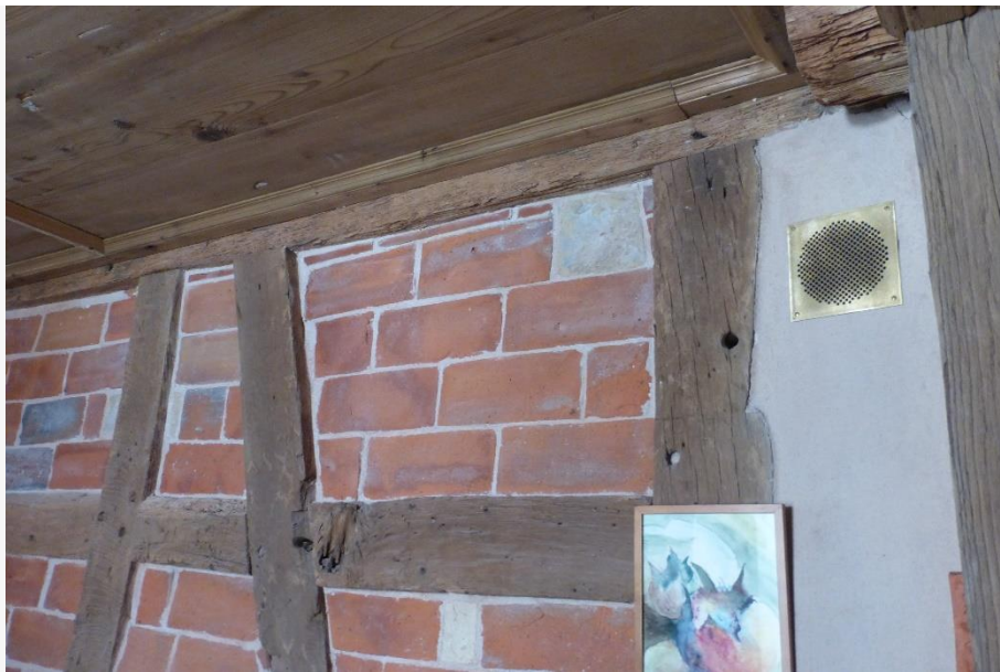
Figure 18 : Bouche de soufflage de la VMC double flux (source : CREBA)
