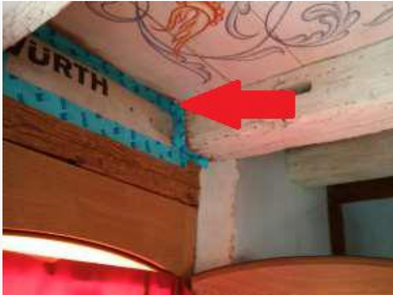
Figure 22 : Traversées de solives et fuites d'air (source : rapport du test d'étanchéité à l'air)
